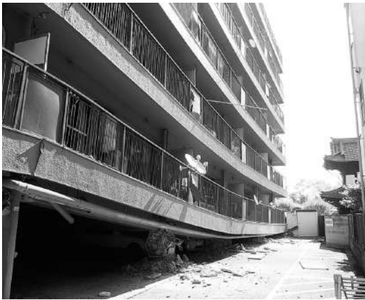
一階の駐車場部分がつぶれたマンション
