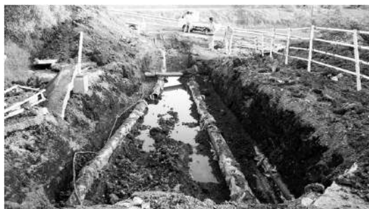
〔地震による水道管被害（抜け出し）〕
