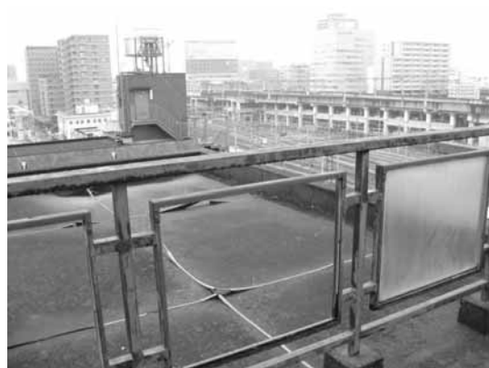
写真1 高崎Uマンション（屋上手すり破損）
