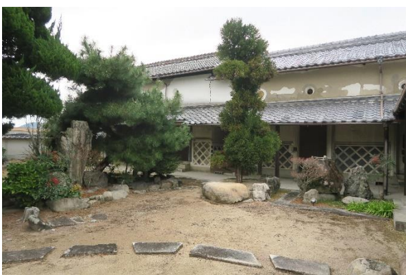
内部より、北土蔵3（右側）と北土蔵4を見る。木製扉、海鼠壁、漆喰塗とも劣化が進んでいる。
