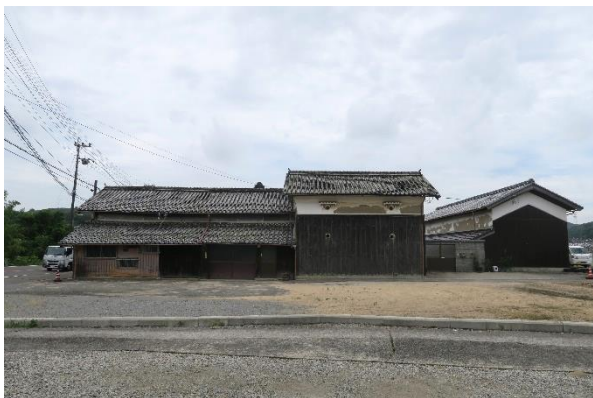
敷地東側から敷地全体を見る。東土蔵の壁漆喰の老朽化が進んでいる。
