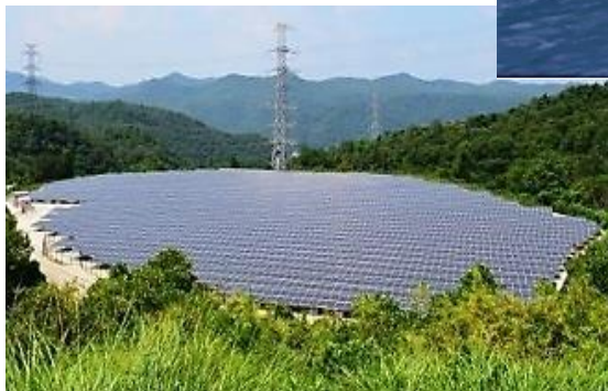
メガソーラー（神戸六甲西太陽光発電所）
