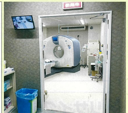
中央市民病院のコンテナ型CT室
