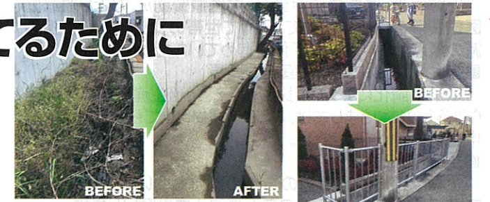
農作物を育てるに水が必要です。しかし、このような状態では十分に供給されません。定期的な水路の清掃や補修は欠かせません。安全のために、新たに柵を設置していただきました。
