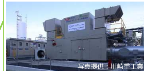
水素エネルギー利用 システム開発実証事業
