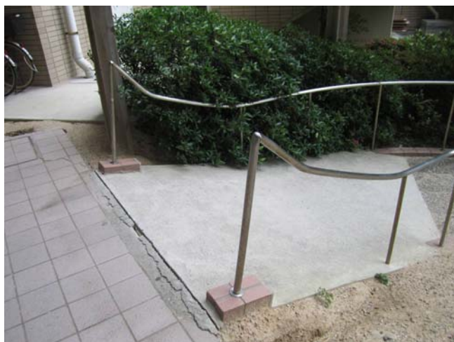
変形した手すり
