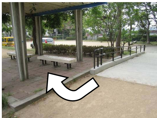
休憩施設への出入口に段差がある (垂水区：東垂水町南公園)
