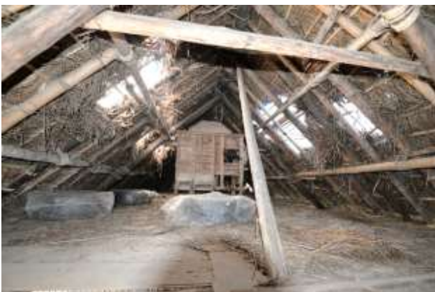
付属屋の小屋組は丸太の又首組で、屋中（母屋）、垂木には竹が使われている。茅葺屋根の劣化が激しく、穴が空いて雨が吹き込むため、竹木舞下地の劣化も激しい。
