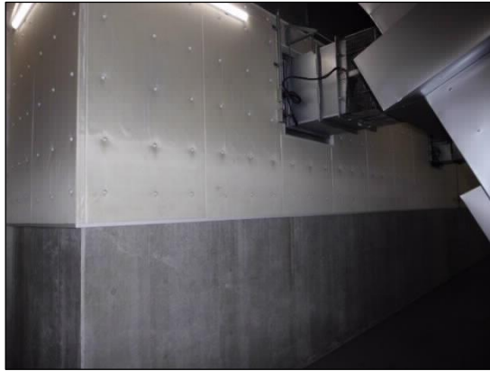
図 3-2-5 吸音材による防音対策（誘引通風機）
