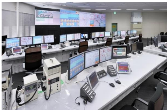
消防管制室の状況
