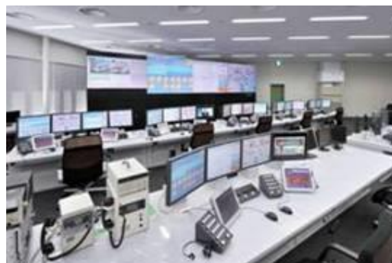
消防管制システム
