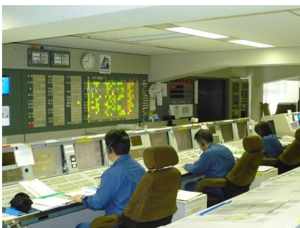
消防管制室の状況
