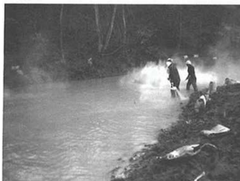
写真 6-35 溜池の漏水止めに用いる粉粘土の散布 散布は、粉状の粘土が周辺へ飛散しないように風雨をさけて行なう。(写真 6-35, 36 は、新潟県長岡市において撮影)
