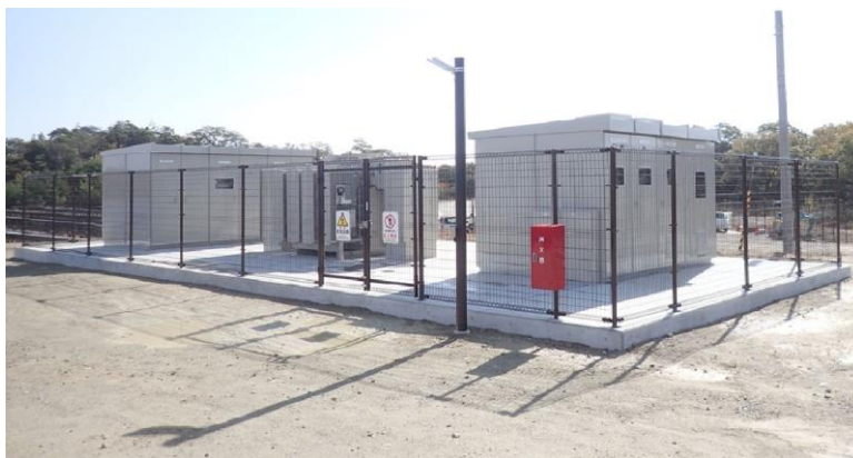
写真 1.4-3 受変電設備（設置イメージ）
