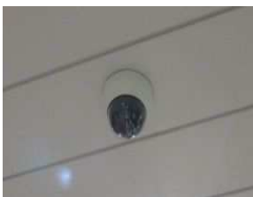
駅構内防犯カメラ
