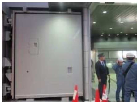
地下街との連絡通路の防水鉄扉(海岸線ハーバランド駅)
