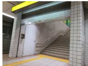
防火シャッター
