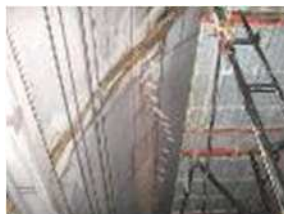
ひびわれ検査
