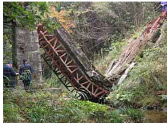
2005(平成17)年11月 香川・徳島県境のトラス橋が落橋（S27年頃架設）
