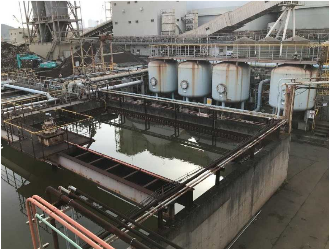
写真 4.2-1 工事排水処理設備の設置状況
