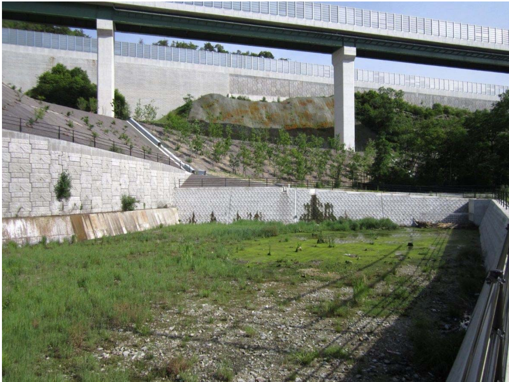
図一七 調整池設置状況（道場 TN 工事）
