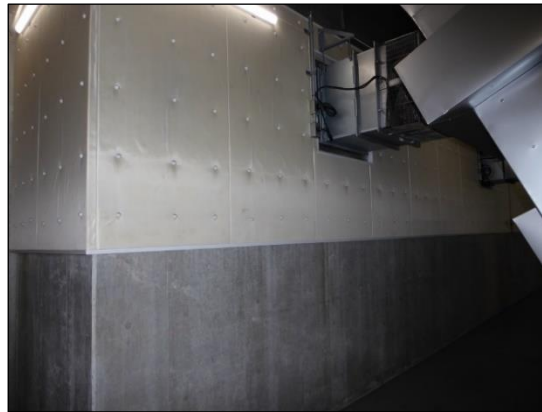
吸音材による防音対策（誘引通風機）
