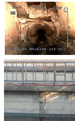
施設の老朽状況
